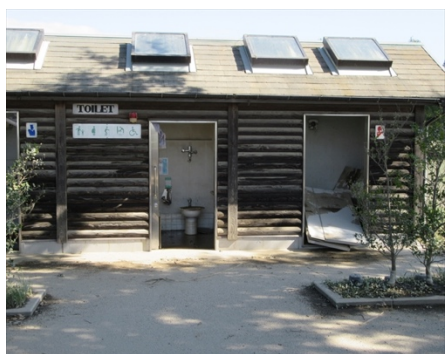
トイレ (完全浸水)
